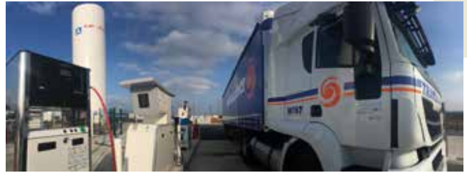
La station multi-énergies permet d'approvisionner sur un même site les véhicules en GNV, bio-GNV, GNL, bio-GNL et azote liquide.
